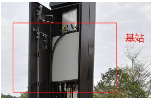
图 3 智慧灯杆中微基站的模样
